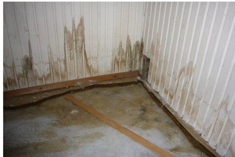
Fugt- og skimmelskade efter indvendig efterisolering af en kælderydervæg. Foto: Arkiv
