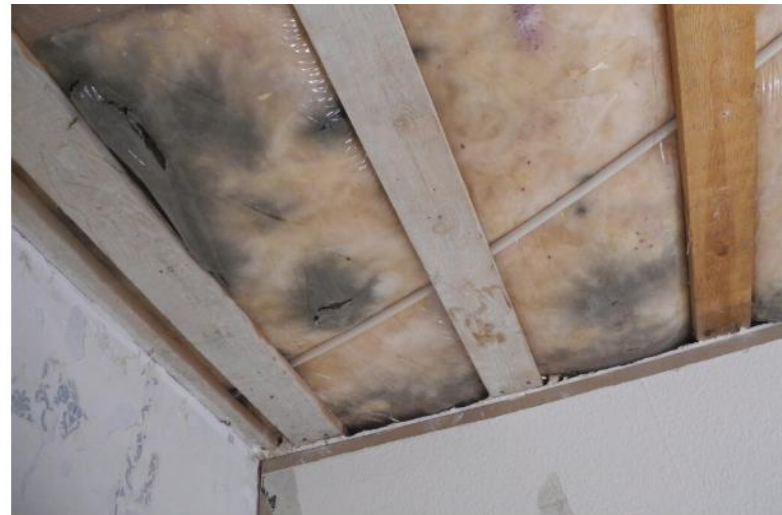
Utæt dampspærre. De mørke områder er der, hvor der er fugtigt. Foto: Bolius
